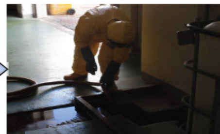
集液坑漏液處理
